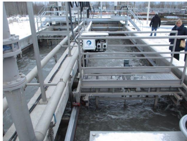
Канализационные очистные сооружения в Петрозаводске, декабрь 2017 года
